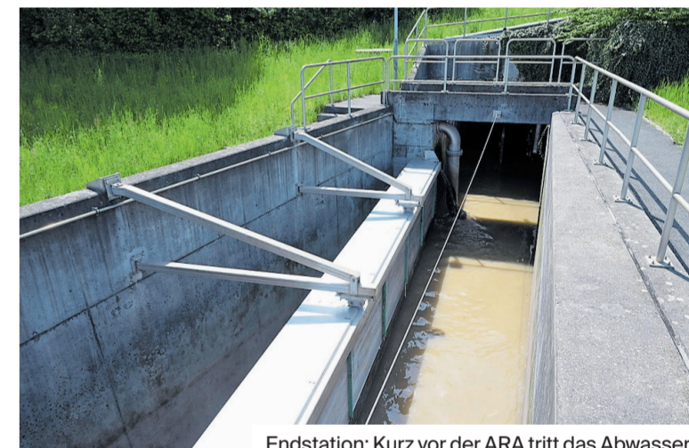
Endstation: Kurz vor der ARA tritt das Abwasser erstmals an die Oberfläche. Bild: Alex Spichale
